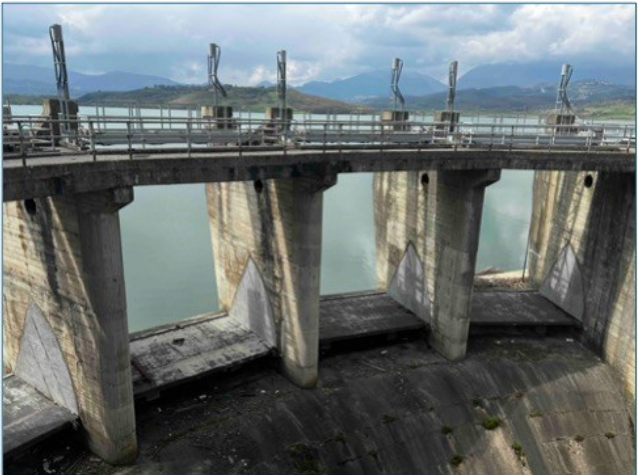
Foto 4. Particolare delle paratoie a ventola.
